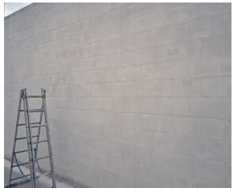
Bild 8 Geschlämmtes KS-Mauerwerk mit KS-Plansteinen
