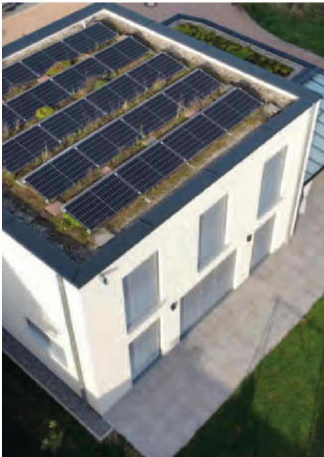
Bild 25 Dach mit Photovoltaikanlage
