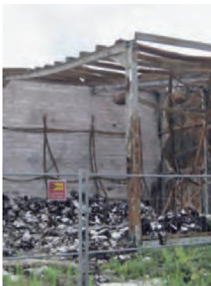
Bild 10 Durch Brand verformte Stahlkonstruktion vor unversehrter Kalksandsteinwand
