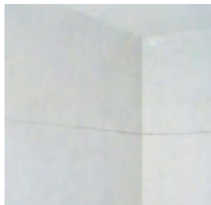
Bild 11 Rissbildung infolge Verkürzung der Decken in Wandlängsrichtung
