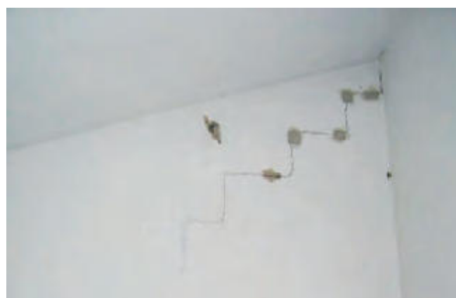
Bild 13 Rissbildung durch Verkürzung eines Stahlbetongurts
